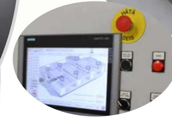
통제 시스템 / 원격 SCADA
